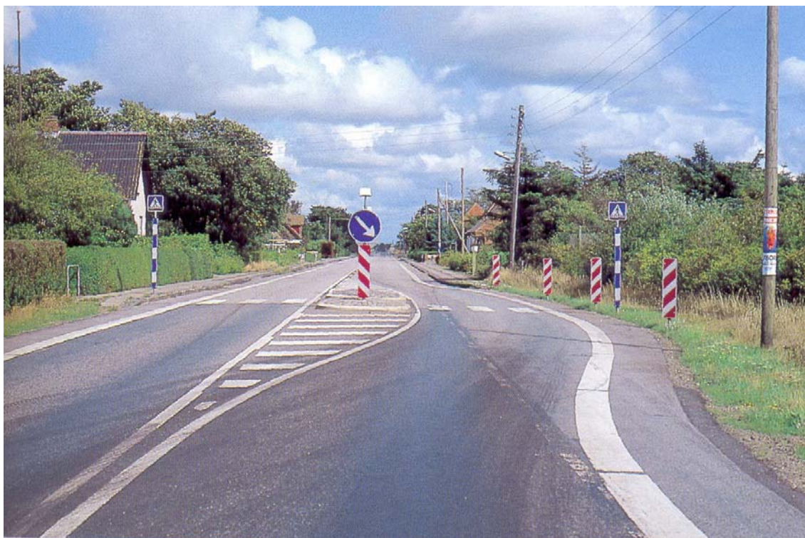
Obr. 7.27 Vybočenie jazdného pruhu
